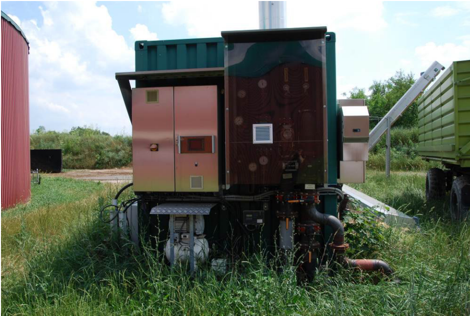
Bild 2: Rückansicht des Trockner-Containers mit Schaltschrank (links) und Teil der Wärmeverteilung (rechts)
