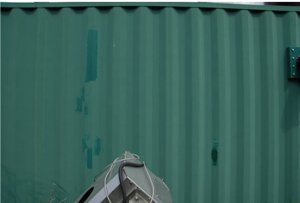
Bild 6: Seitenansicht links, ausgebesserte Schäden in der Lackierung
