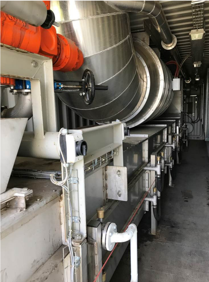
Bild 9: Trogkettenträger mit Abluftkanal und Separator (links, orange)
