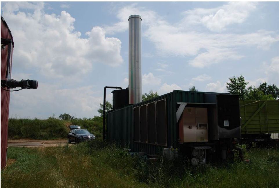
Bild 3: Container des Trocknercontainers, Seitenansicht rechts mit Heizregister
