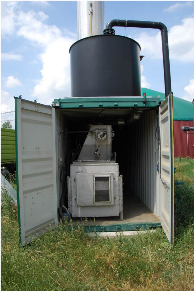
Bild 7: Geöffneter Trockner-Container mit äußerem Luftkanal (Containerinnenraum), Trogkettenträger und aufgebautem Separator
