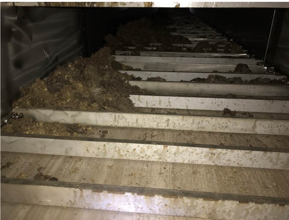
Bild 17: Oberes Band im Trogkettenförderer mit Resten von Trockengut
