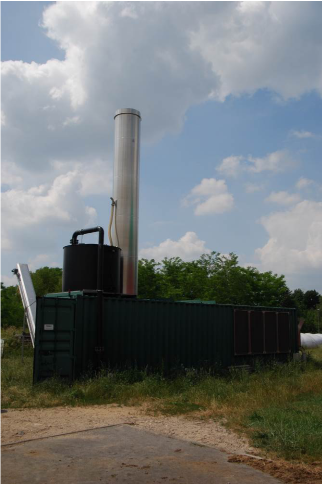
Bild 4: Container mit Trockner, Seitenansicht rechts
